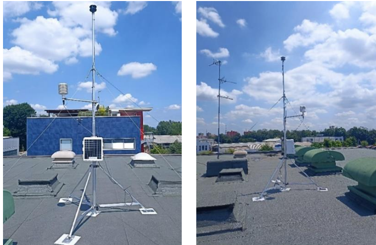
Figura 2: foto del palo meteo installato dai tecnici ARPA sul tetto di Oltrebar - via Newton 12/14 Pero (MI)
